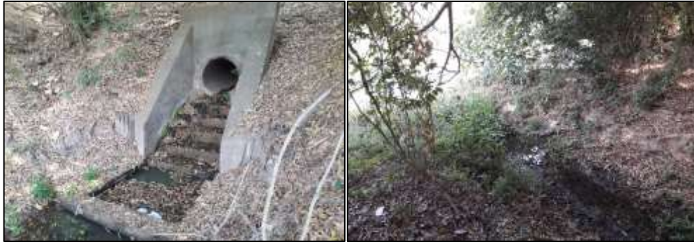
Figura 5 - Mosaico de fotos que mostram galerias de esgoto lançando efluentes no rio Poti
